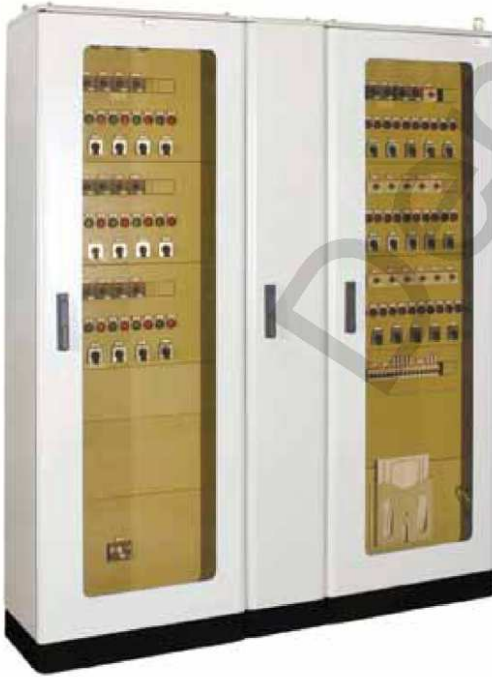
Dikili Sistem MMC Pano Uygulaması
